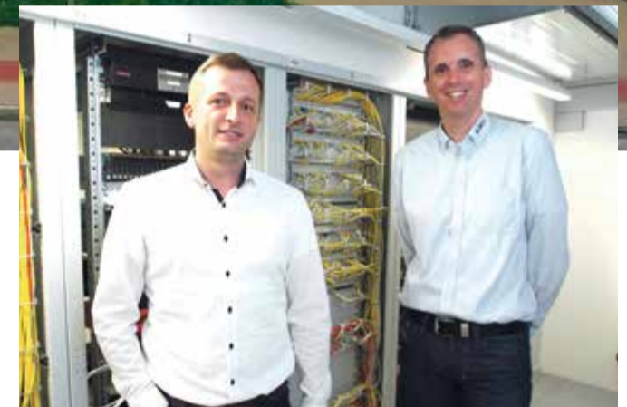
Fototermin im Serverraum: Geschäftsführer Oliver Seib (rechts) stellt sich den Herausforderungen der Digitalisierung und rüstet auf. Mit Pavel Walz stellt er einen Mitarbeiter als Standortleiter für die neue Viridicon Primus GmbH ab. Fotos: Wolfgang Becker
